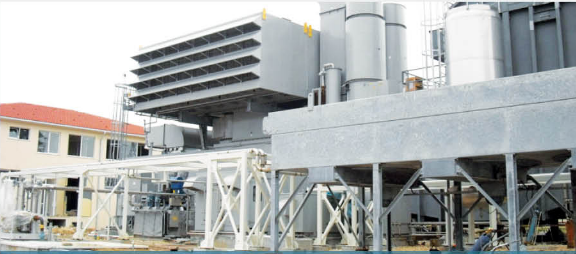
Uğur Enerji Doğal gaz çevrim santrali
